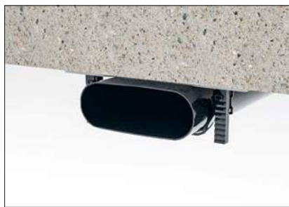
Kanał płaski na suficie w piwnicy
